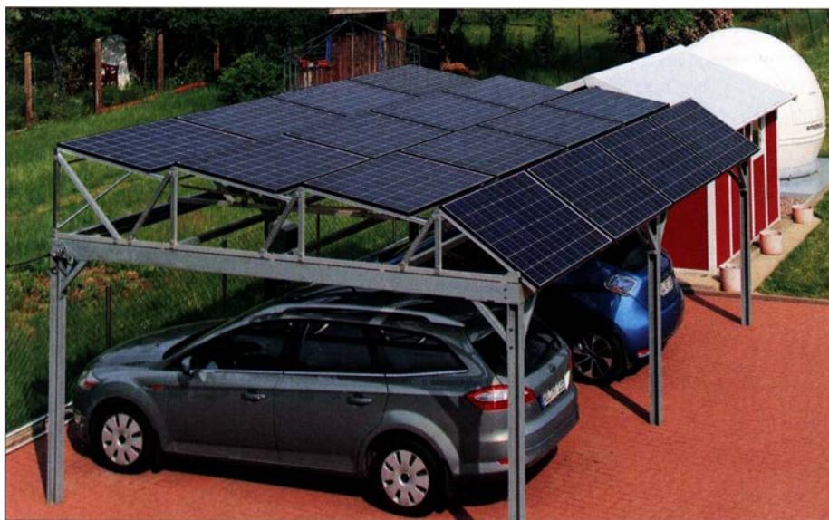
Bild 1: Im Vollausbau der hier beschriebenen Anlage zur Hausstromversorgung sind insgesamt 15 Solarmodule installiert. Ein weiteres Modul ist für die Versorgung meiner Sternwarte bestimmt. Jedes liefert eine Arbeitsspannung von 30 V bis 32 V und einen Strom von maximal 8 A. Fotos und Screenshot: DK6AE
