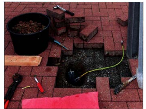
Bild 5: Die Stahlkonstruktion erfordert eine fachgerechte Erdung.
