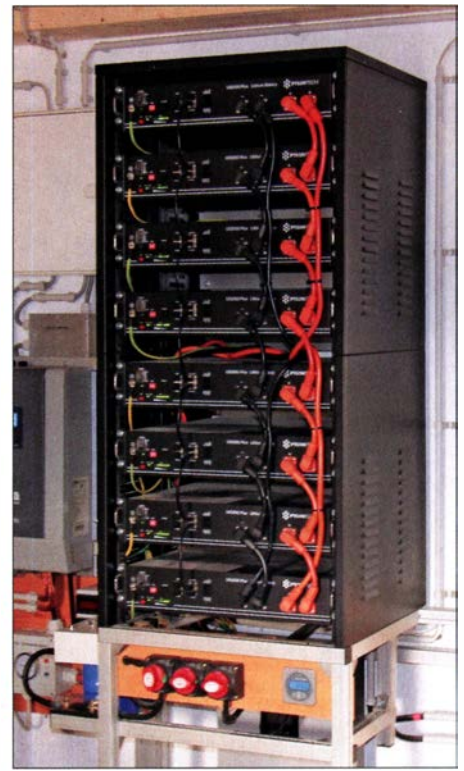
Bild 8: Die Hausstromversorgung ist im Vollausbau mit acht 48-V-Speichereinheiten bestückt. Diese sind in einem Gestellrahmen untergebracht und bieten eine Nennkapazität von insgesamt 19,2 kWh.
